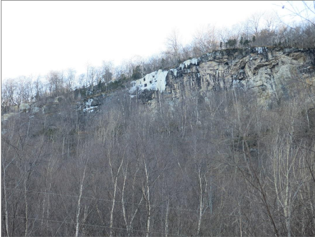
Bilde 5. Nærbilde av større brattskrent i den aktuelle skråningen, med mye is- og sprekkedannelse. Bildet er tatt fra veien mot sørvest.
