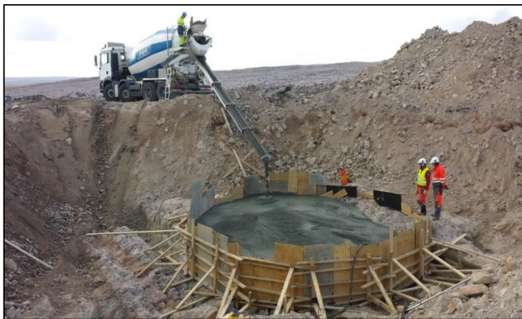
Figur 3-1. Støping av turbinfundament i Raggovidda vindkraftverk. Mest sannsynlig vil det bli valgt samme type fundament på Nordre Sørøy. Foto: Multiconsult Norge AS.
