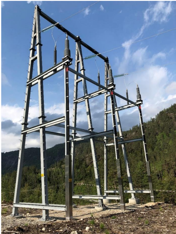
Figur 1-17. Bildet viser en kabelendemast. En slik kabelendemast er planlagt ved Såheim og sør for Svineroivegen, der den ledningen Mår-(Såheim)-Vestfjorddalen går fra luftledning til jordkabel.
