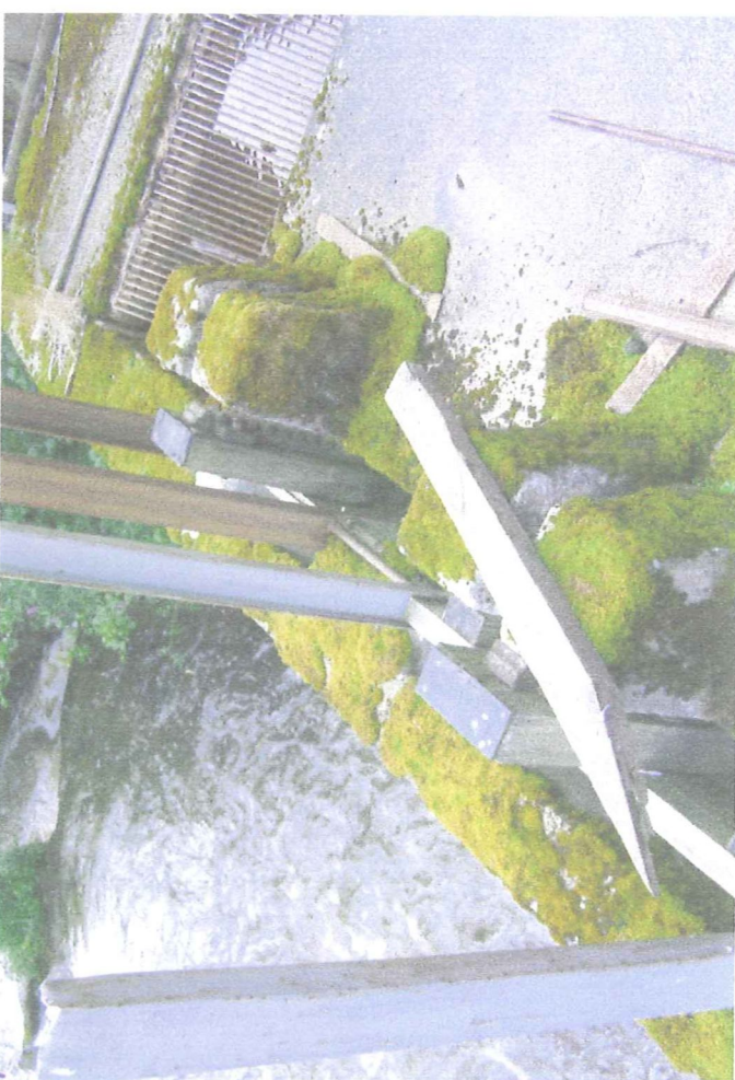
Intaktskanal med svinger for flömluckor
