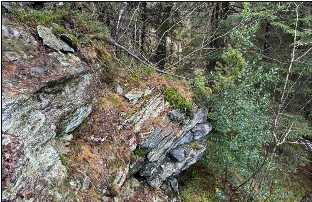
Figur 4: Skrenten nord på tomt A har en del sprekkeavgrensede blokk, samt et sprekkesett som faller innover i skråningen.
