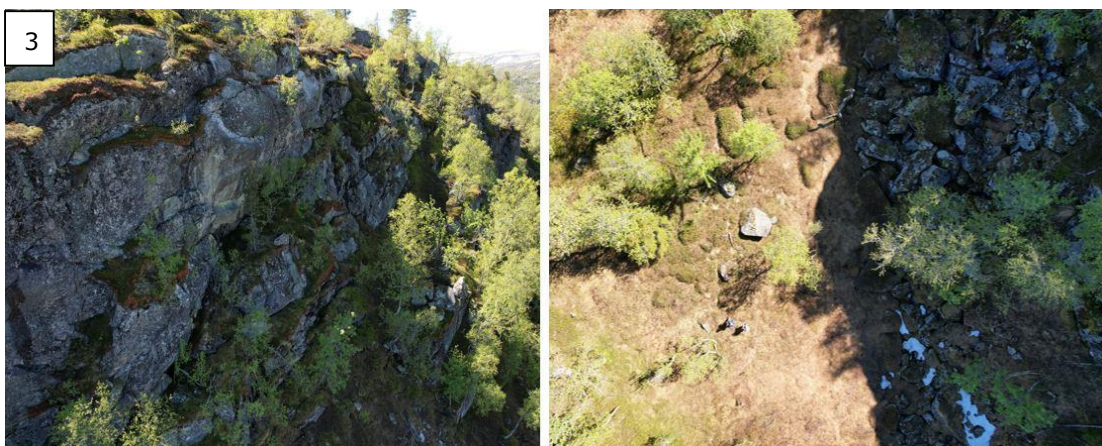
Figur 14. Overheng i skrenten i nord vises i bildet til venstre. Det ligger grov ur og enkelte spredte og store blokker nedenfor, men avgrensningen for utløp av steinsprang er likevel ganske tydelig (høyre bilde tatt ovenfra).
