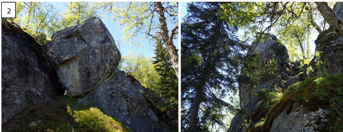
Figur 12. Stor blokk utgjør mye av fjellsiden ved punkt 2 i registreringskartet. Se person på bildet for skala. Blokken er avgrenset av et skar i bakkant og står kilt/hviler mellom fast berg i den ene siden og en stor blokk i den andre siden. Det er liten sannsynlighet for at blokken skal rase ut, og utløpslengden er begrenset.
