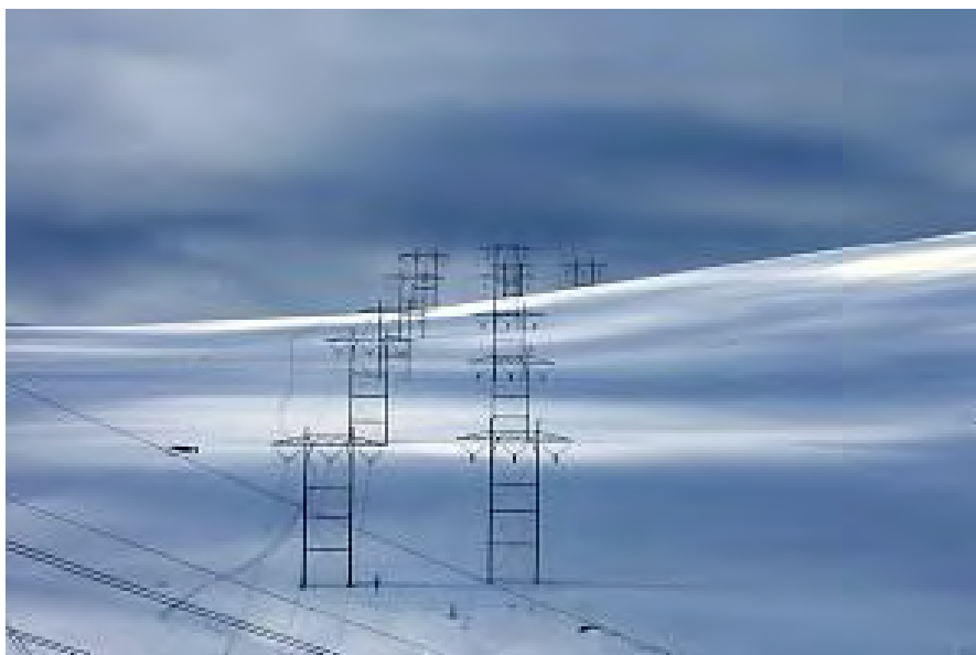
Figur 15: Parallele traséer oppfattes gjerne som mest ryddige når man har samme mastetype. Her er 132 kV ledningene mellom Kvandal – Kanstadbotn og Kvandal – Kvitnes. Foto: Statnett.
