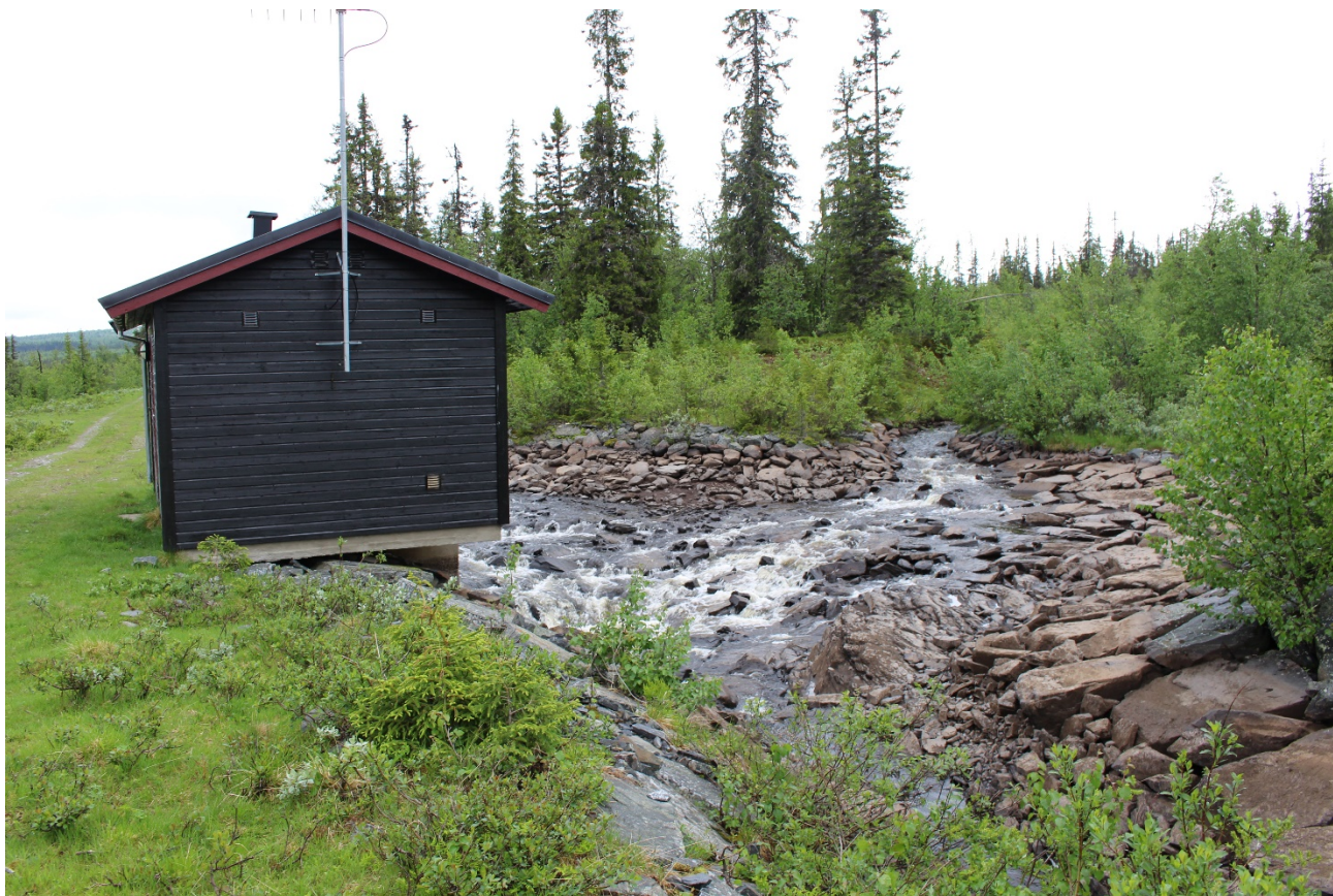
Inntakspunkt for Vålåa på overføringskanalen fra Ropptjern til inntaksbasseng Roppa kraftverk, 22.6.2021
