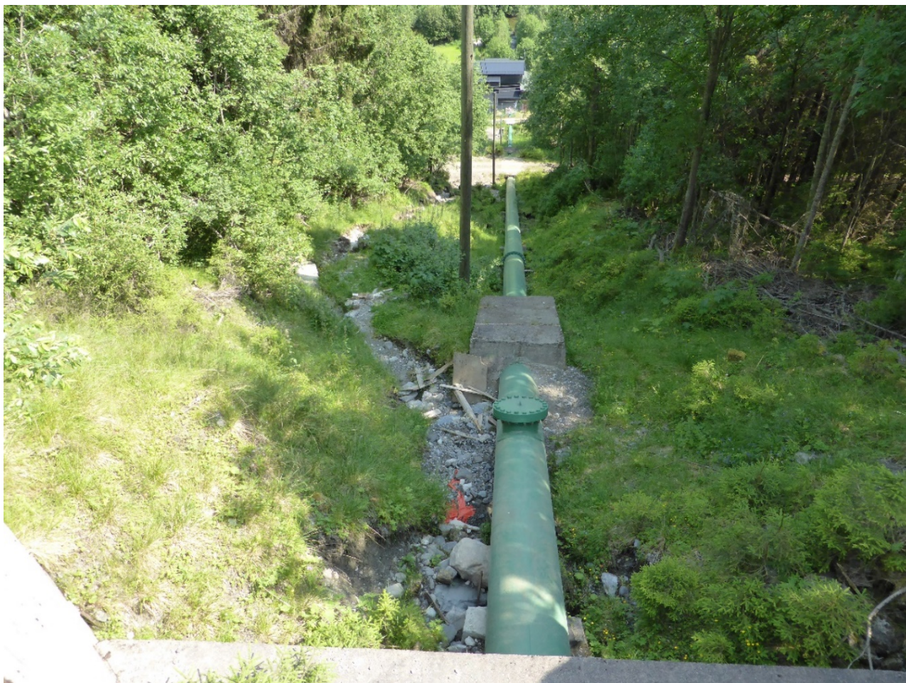
Rørgate til Roppa kraftverk, 11.7.2013
