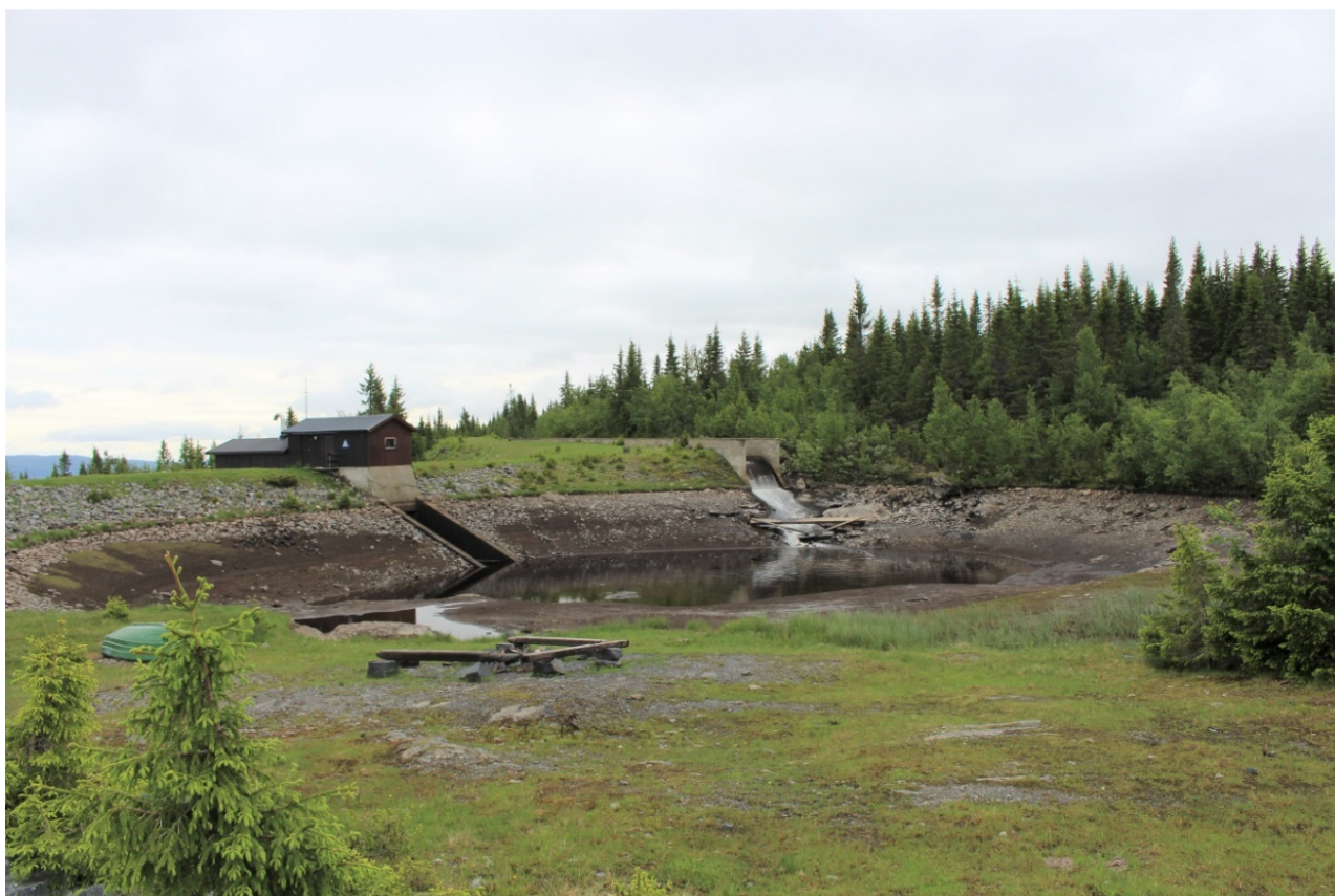
Inntaksbasseng til Roppa kraftverk (nedtappet), 22.6.2021
