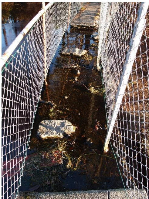
Flomløpet er sterkt erodert
