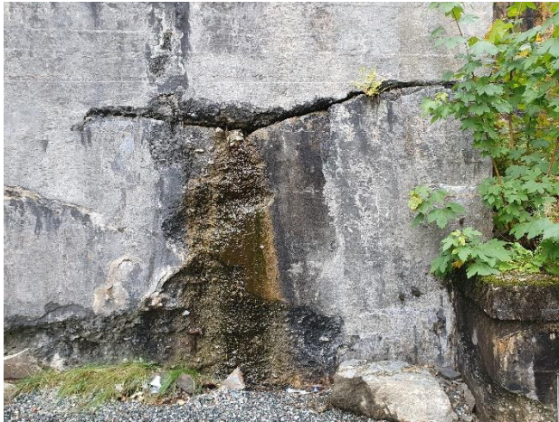
Skader i betongen på silkammeret
