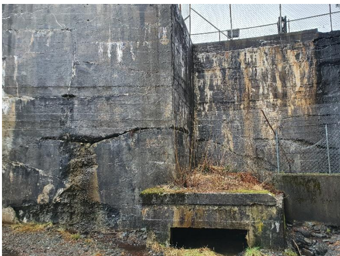
Et ventilkammer/silkammer er bygget sammen med dammen
