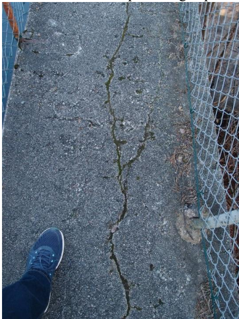
Langsgående sprekk i toppen av damkrona langs hele dammen
