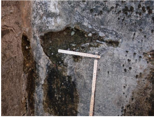
Betongen på luftsiden har relativt store skader
