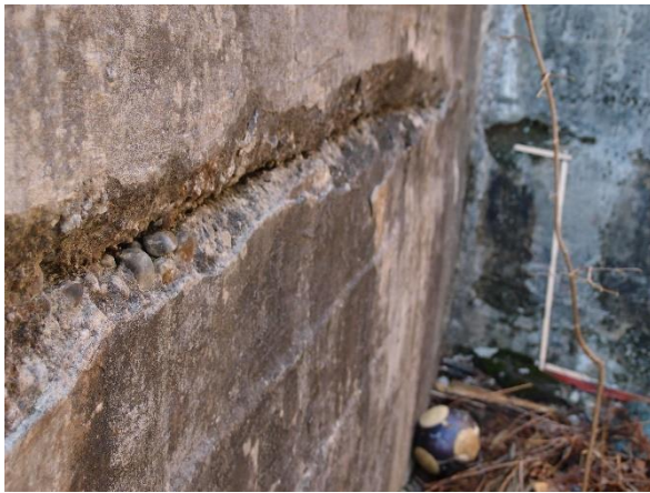
Relativt store skader på betongen på luftsiden, noe synlig armering
