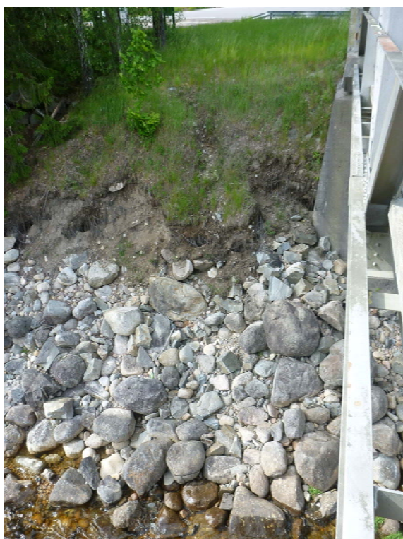
Figur 3.11 Fv. 3756 bru, erosjon nedstrøms landkaret. Foto: J. Sauterleute
