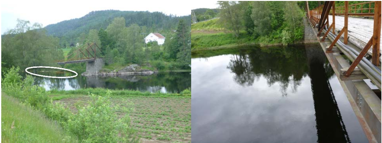
Figur 3.7 GS-bru Mollestad, landkar på vestsiden av elva (venstre); og landkar på østsiden (høyre). Avsetninger av fin sediment er avmerket med hvit ring. Foto: J. Sauterleute
