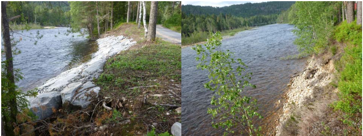
Figur 6.2 Erosjonssikring ved Birkeland og tegn på erosjon på venstre bredd nedstrøms GS-brua Birkeland – Lunden. Foto: J. Sauterleute
