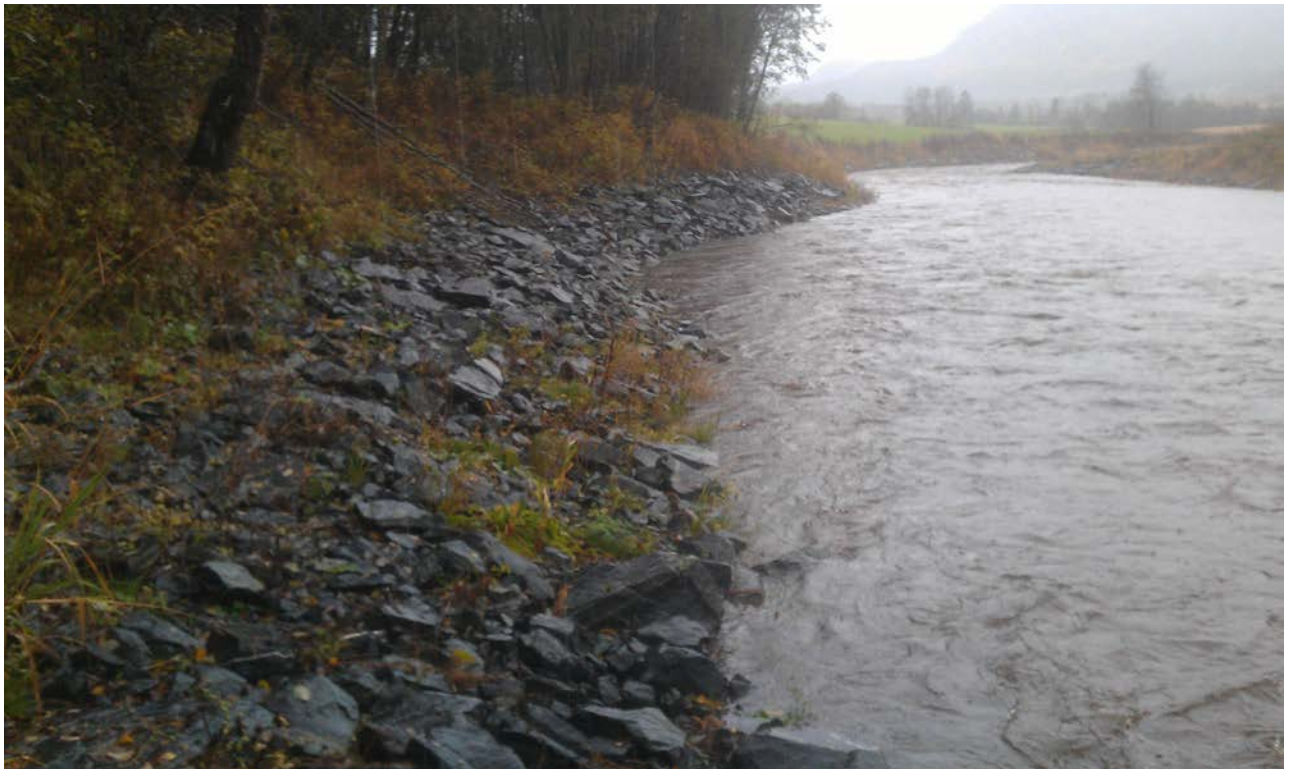
Figur 1: Erosjonssikring ved foten av skråningen ned mot Østerelva i ca. profil 290
