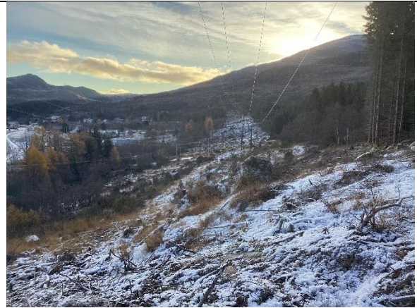
Figur 25 Mellom mast 21 og mast 20. Her er det ikkje køyrt.
