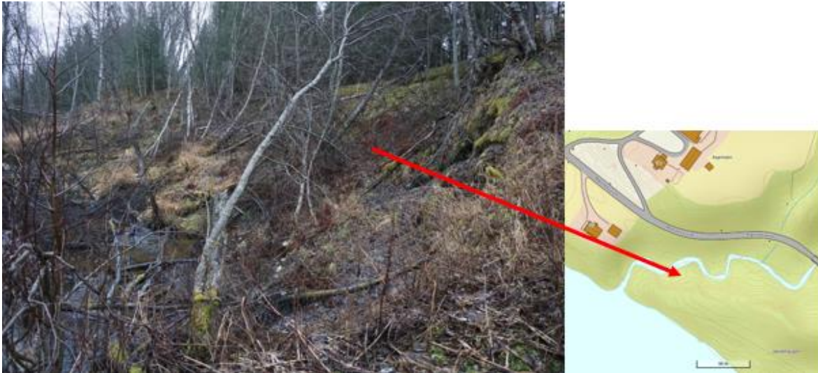
Figur 4. Fiskebekken, kraftig erosjon
