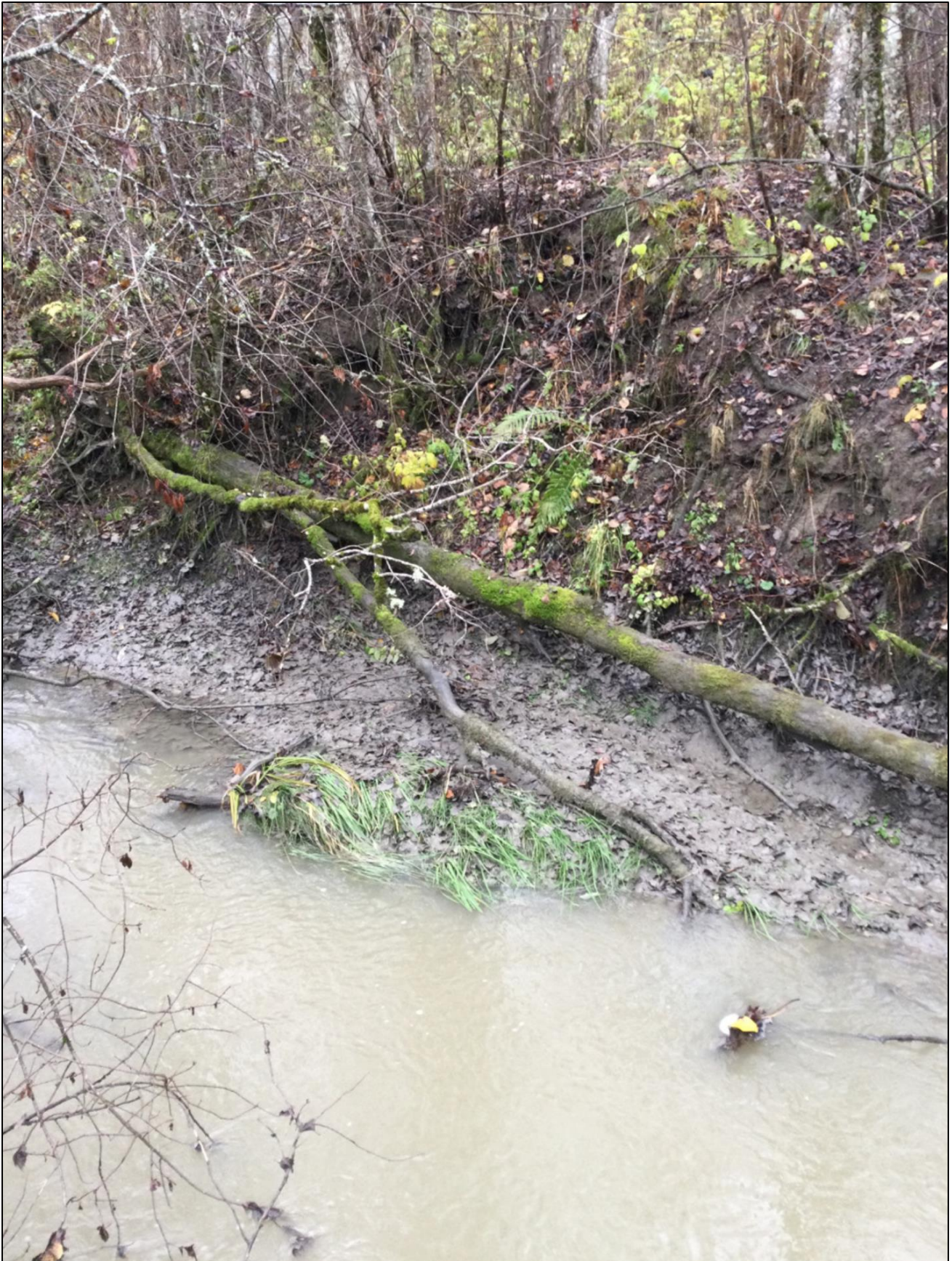
Bilde 18 (utglidning mot nordøst, noe erosjon)
