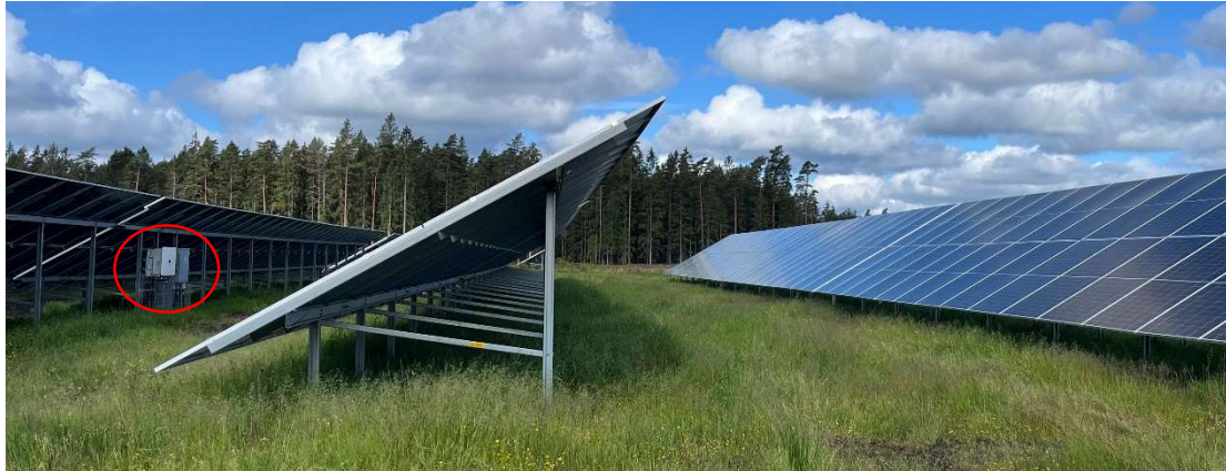
Figur 2-9 Eksempel på et bakkemontert solkraftverk med solceller montert i montasjestativ på bakken. Solkraftverket på bildet ligger i Sverige, heter Henja, og er eid av Aneo..
