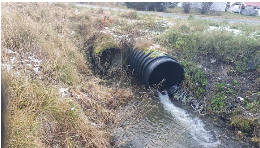
Figur C. Stikkrenner under H. M Holst vei. Høyre stikkrenne er knekt ved utløp.
