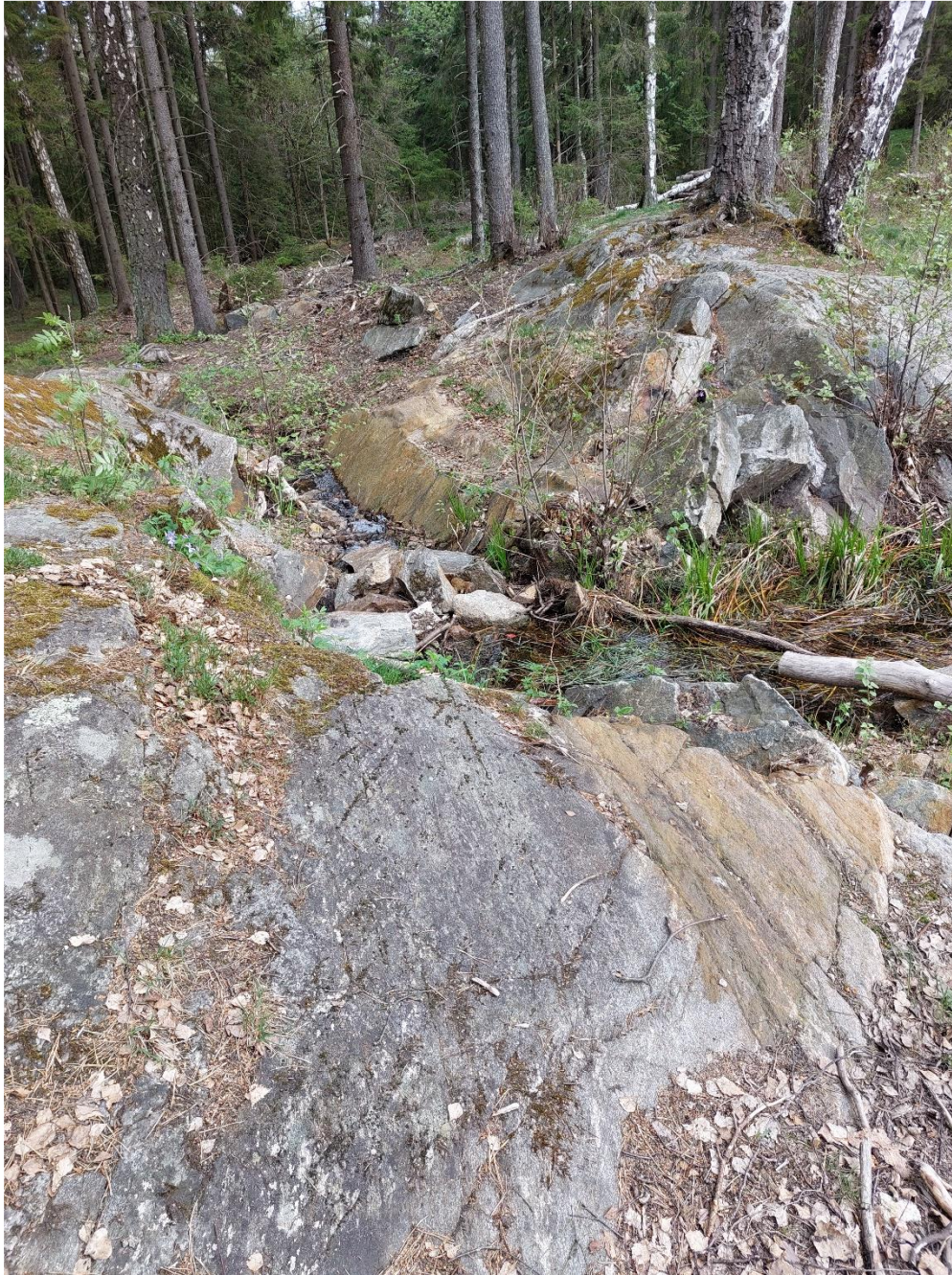
Bilde 7. Flomløpskanal ved sperredam 2. Delvis tilstoppet med stein av dammens besøkende (Foto: Civil Consulting)
