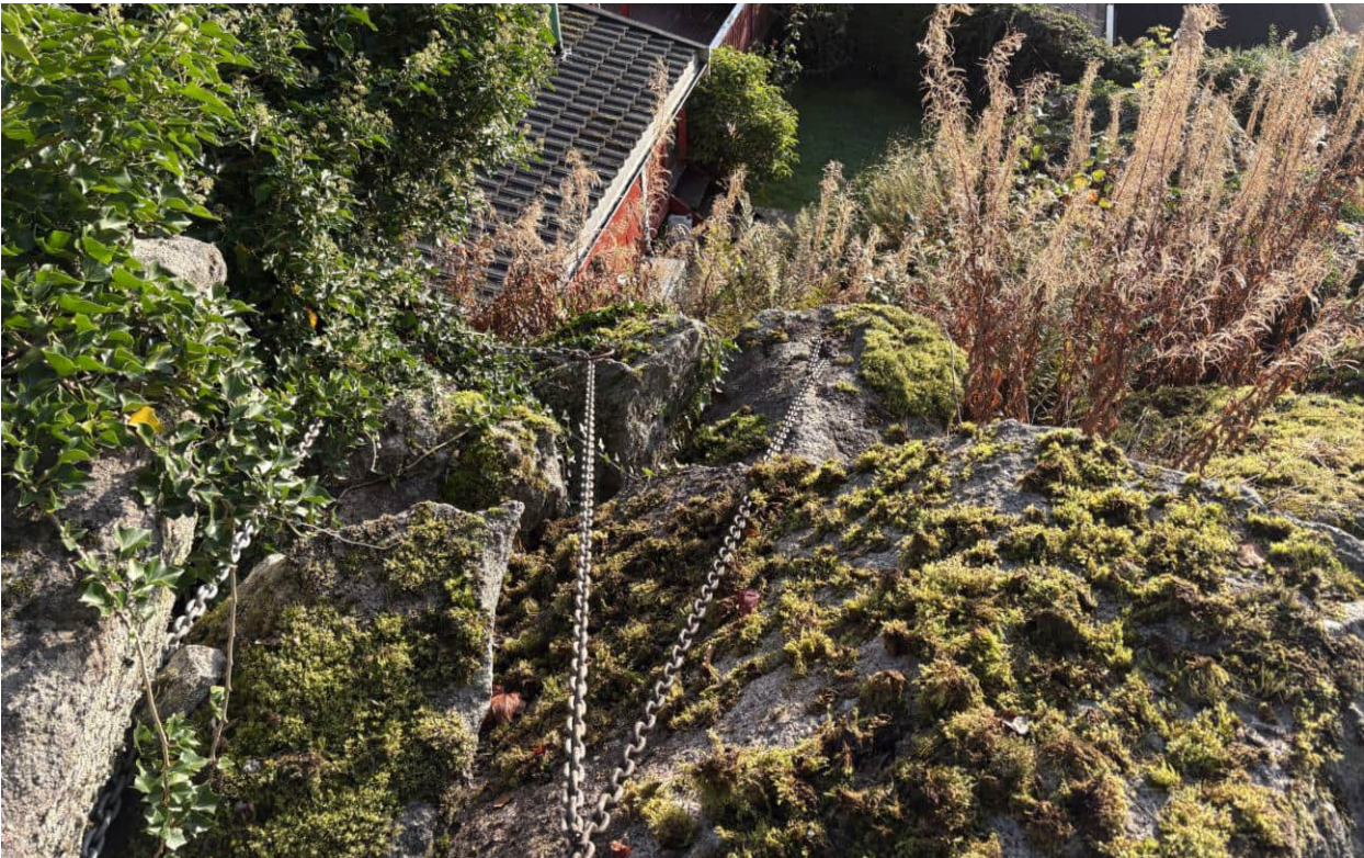
Bilde 4: Steinsprangblokker på kanten av skråningen som er sikret med øyebolter og kjetting. Sett mot øst. Infopunkt 2 i Vedlegg 4.
