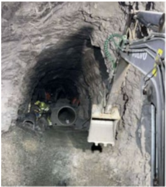
Rør i grøft i tunnel (P2200- P2750)
