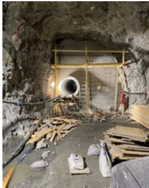
Gjennomføring rør i betongpropp (P2200)
