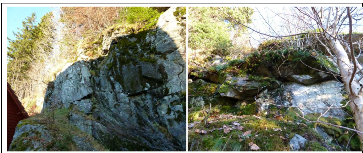
Figur 7 Bildet til venstre viser oppsprukket berg mellom garasje og hus ved Vallaheiane 119. Bildet til høyre viser området markert i Figur 6 med stor sannsynlighet for skred/steinsprang.
