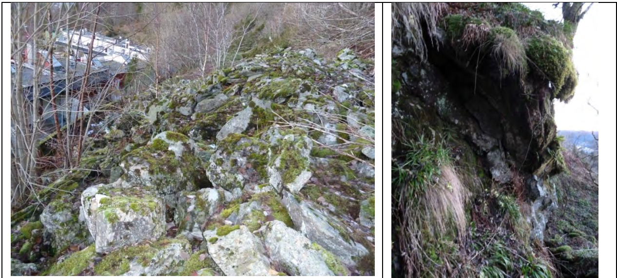
Figur 9 Bilde til venstre viser urmasser ovenfor bebyggelse i Vallalia. Bildet til høyre viser oppsprukket bergknaus ovenfor bebyggelse 52-72. Knausen har glideplan omtrent parallelt med skråningen med strøk- og fallretning N164^\circ/74^\circ V .
