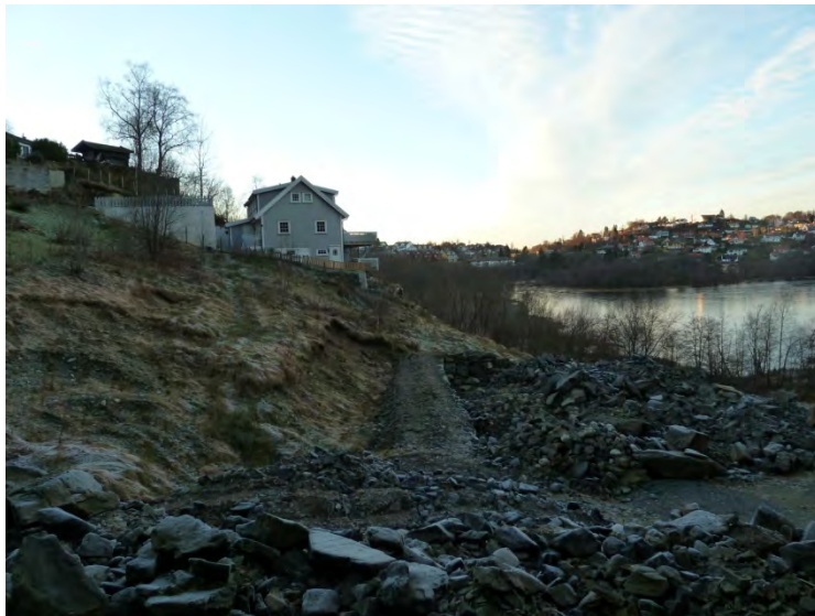
Figur 20 Menneskelige inngrep i løsmasser nedenfor Birkelandsbotn 21A-B og 23, graveskråning.
