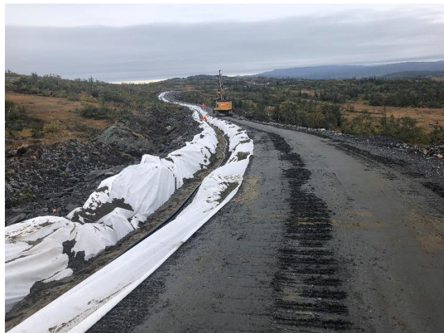
Bilde 5: Legging av 33 kV kabler i forbindelse med Stokkfjellet vindpark i 2020. Foto: TrønderEnergi
