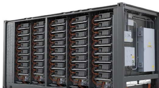
Figur 4: eksempel på batterikontainer med LFP-batterier
