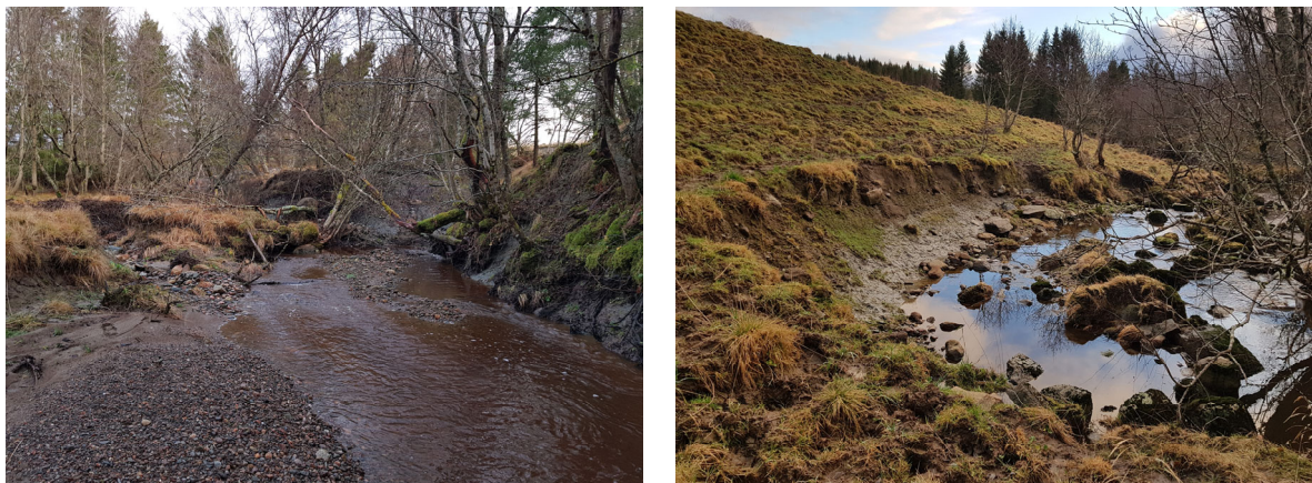
Figur 2: Bilder tatt på befaring som viser erosjon langs Steinselva (foto: NVE)
