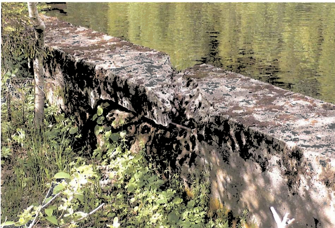
Midtre Askdam, juni 2009. Parti med betydelig avskalling og forskyvning.
