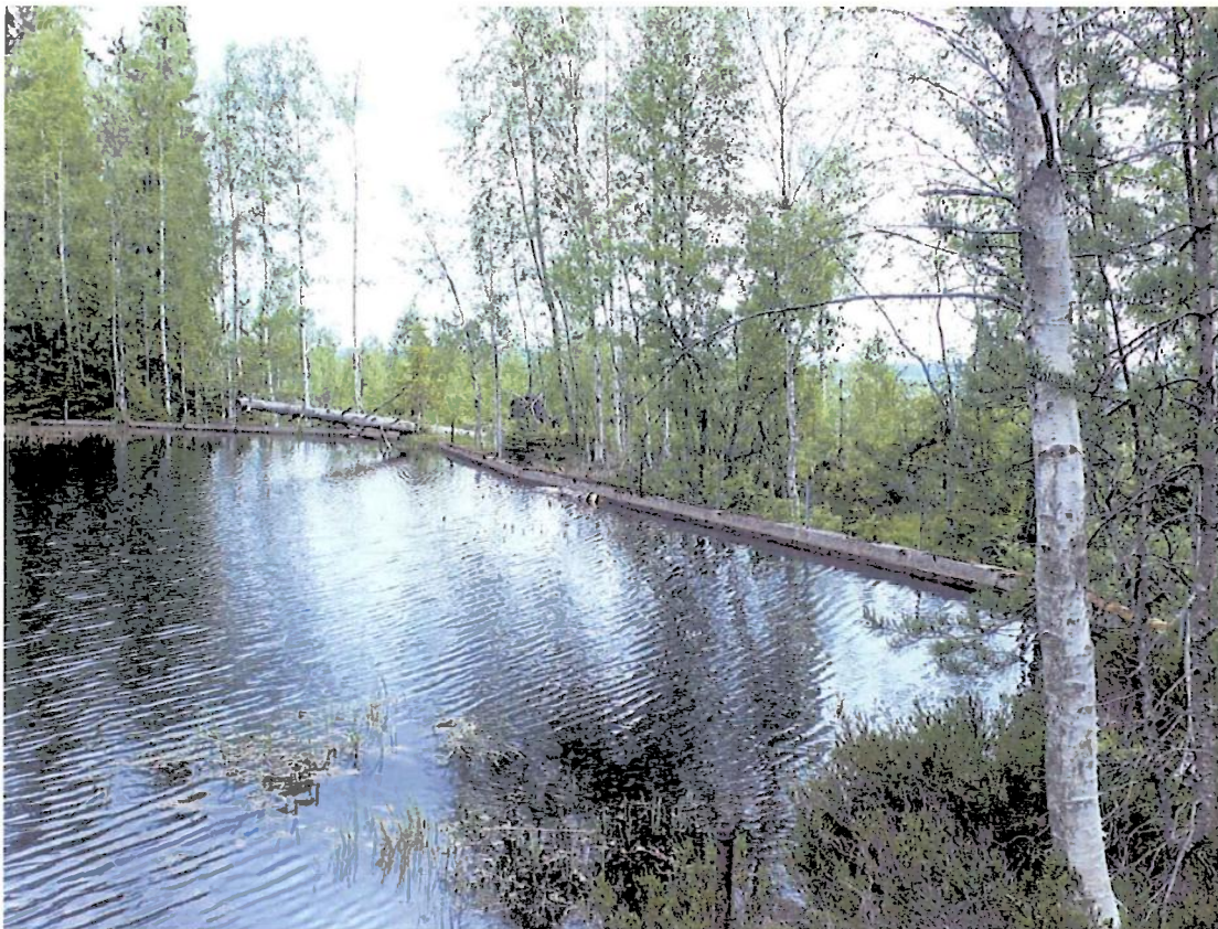
Øvre Askdam, juli 2009. Den lavere delen av dammen som har tydelige deformasjoner.
