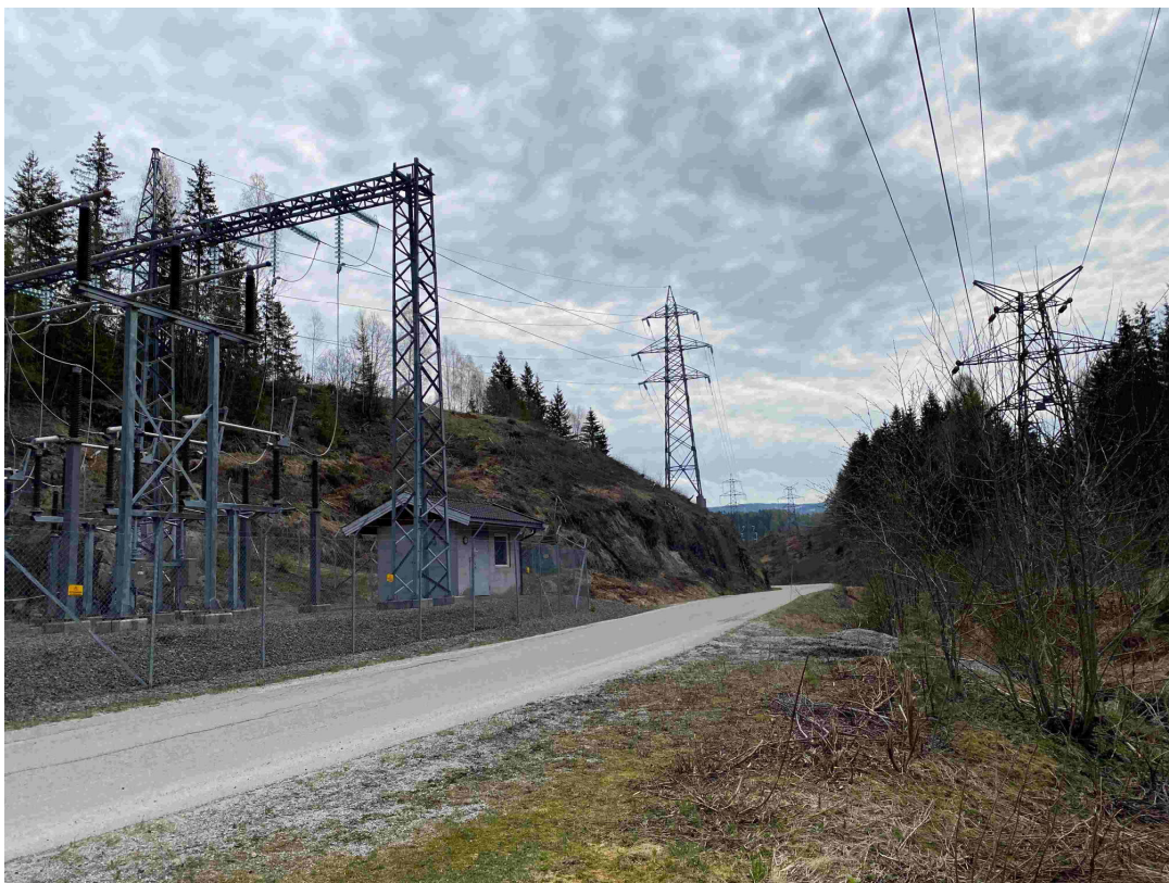
Figur 4 Eksisterende Kaggefoss transformatorstasjon langs Kaggefossveien. Ledning til høyre i bildet (50 kV Kaggefoss-Bragernes) skal saneres.
