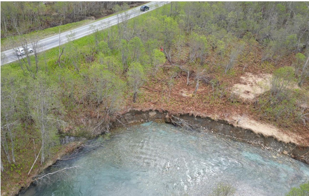
Foto 4: Erosjon i elven ved profil 1600, se tegn V06-03. (Foto: H.Lissman)
