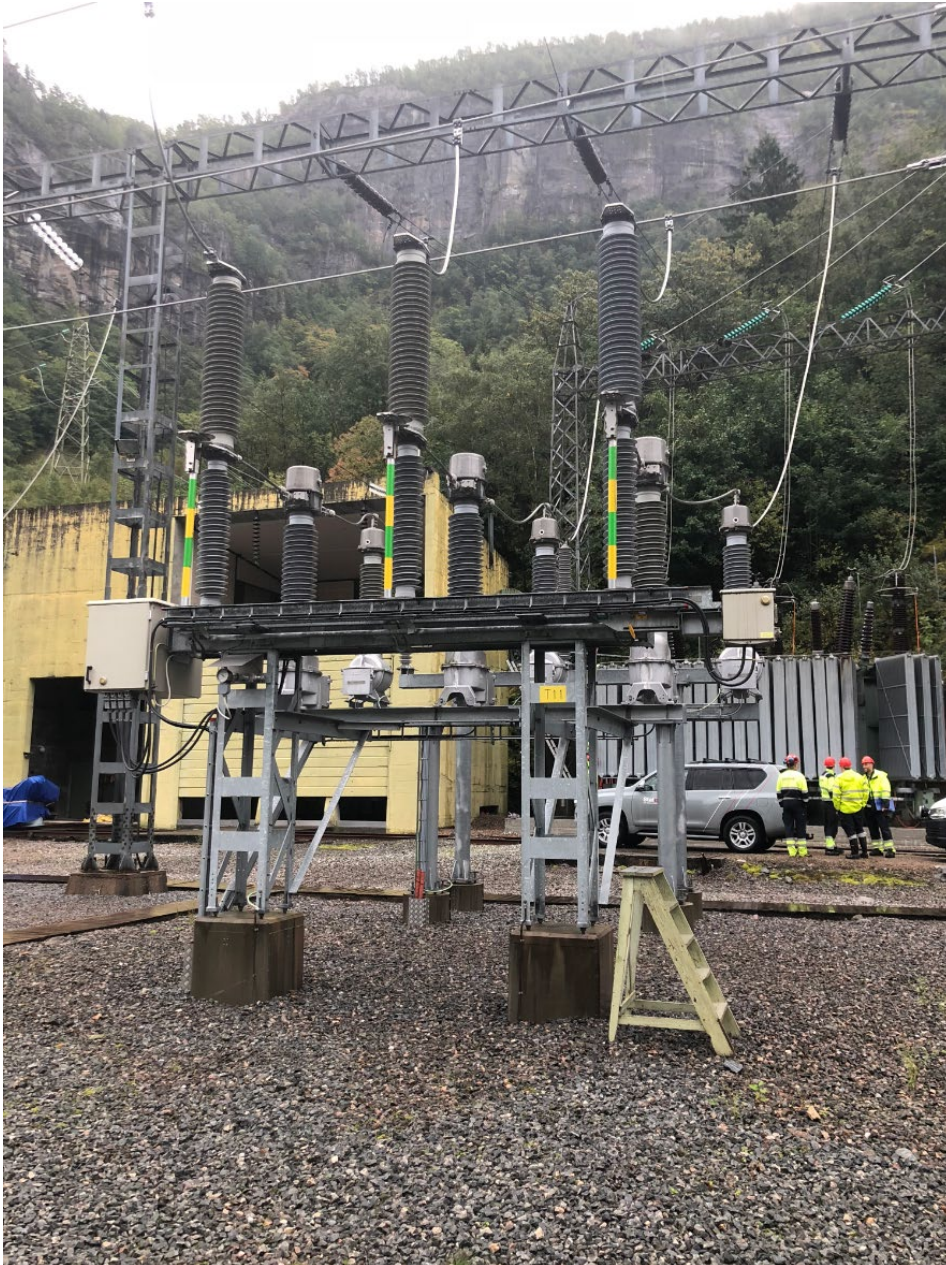
Figur 2 Bak bilen ser man dagens 300/132 kV transformator. Denne skal rives og erstattes av ny transformator i nye Dalekvam stasjon. Ledningen som da vil føre 132 kV planlegges strukket fra stativ og inn til innstrekksstativet.
