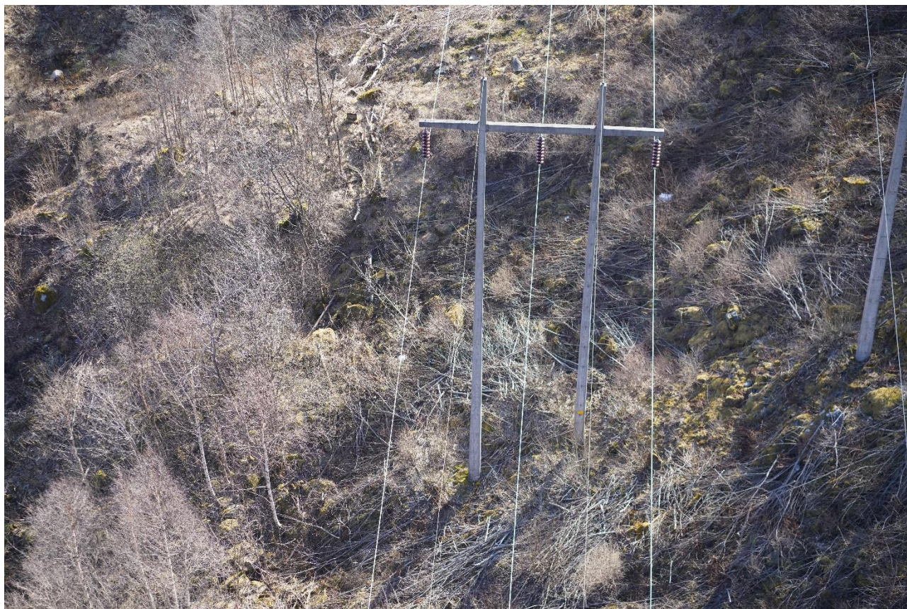
Figur 5-6: Betongmast i traseen mellom Såheim og Rjukan næringspark T5.
