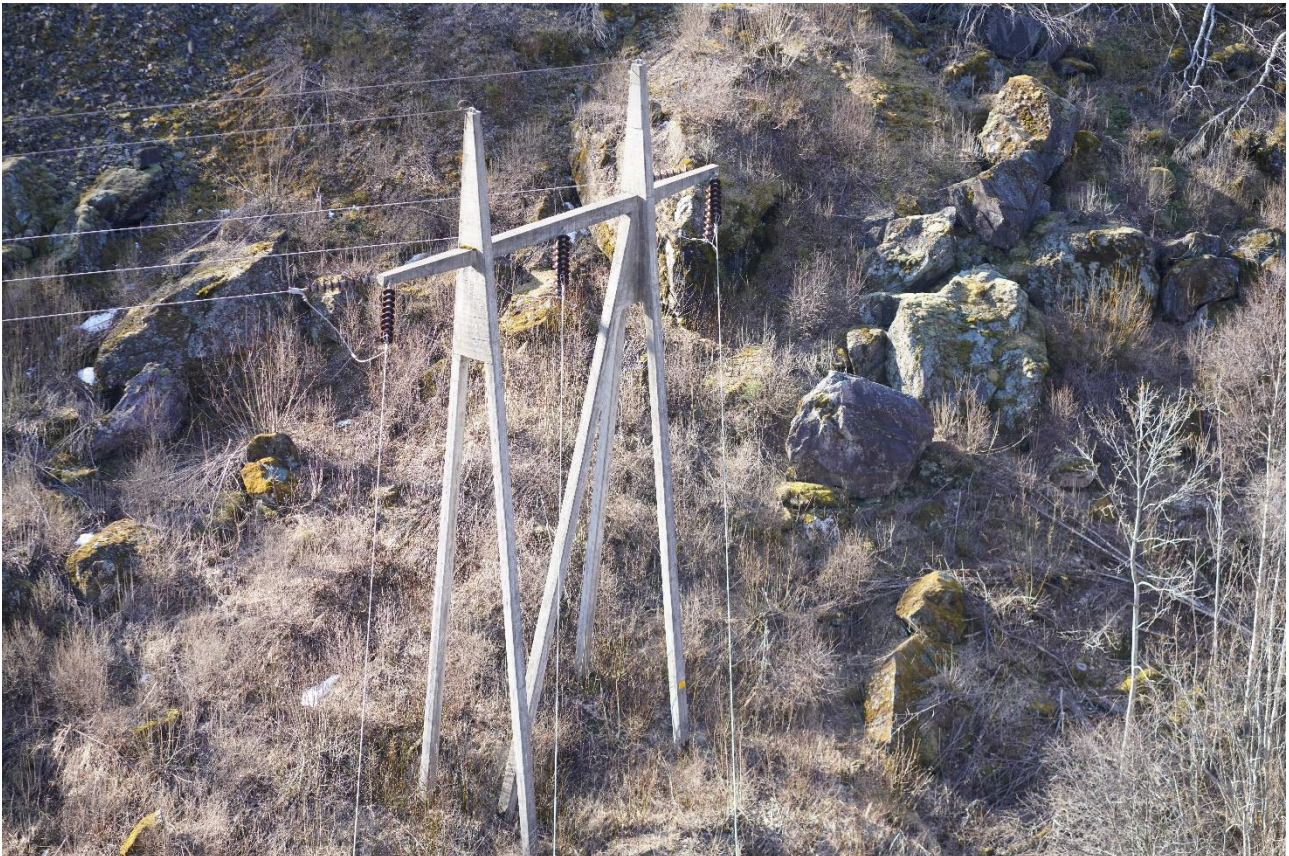
Figur 5-5: Vinkelmast ved Rjukan næringspark T5.
