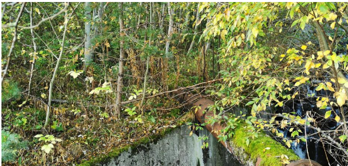
Figur 3 – Ledning oppstrøms bekkekryssing
