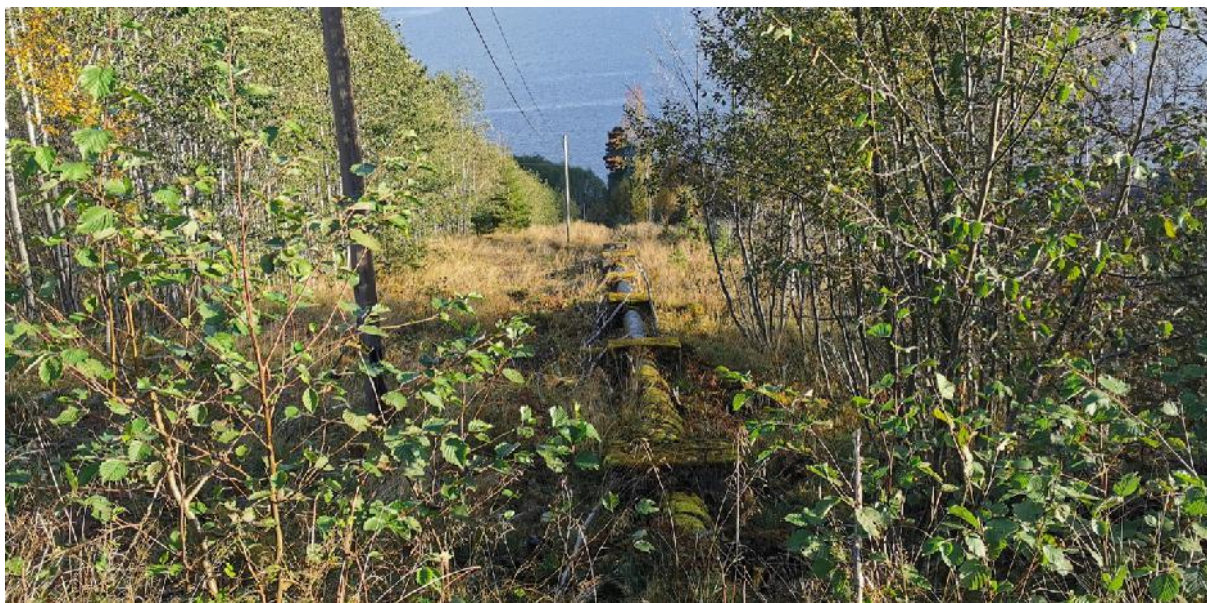
Figur 13 – Ledningstrase med ledning i dagen
