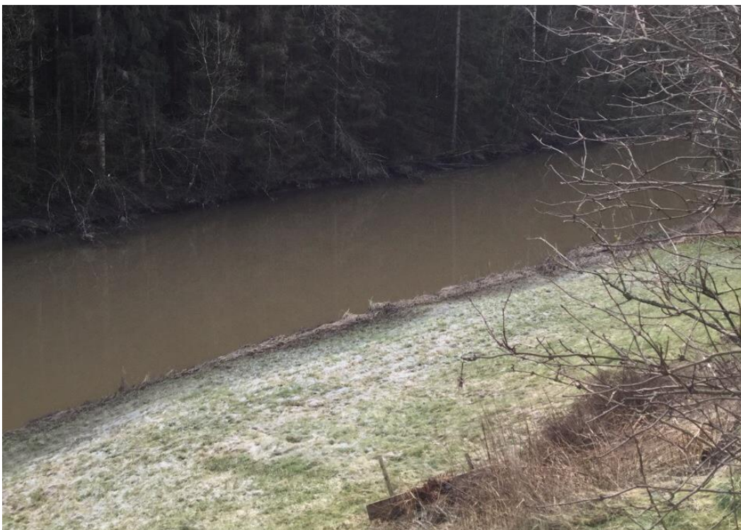
Figur 5. Bilde av elvebredden ved Elveveien 87, tatt i retning sør. Observert grumsete vann og aktiv erosjon langs elvebredden.
