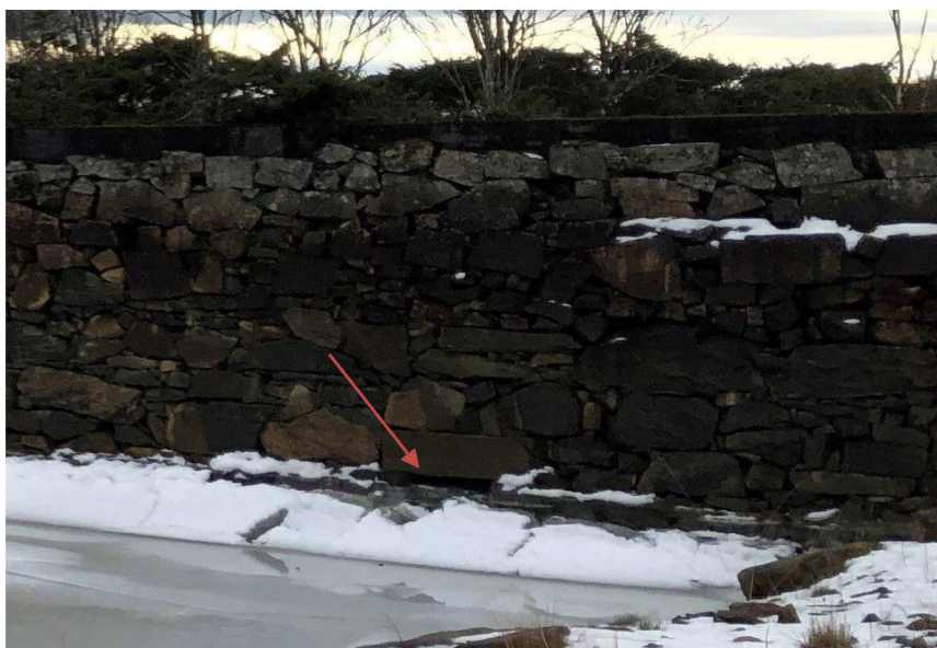
Bilde 7 Antatt «tunnel» gjennom hoveddam vist med rød pil
