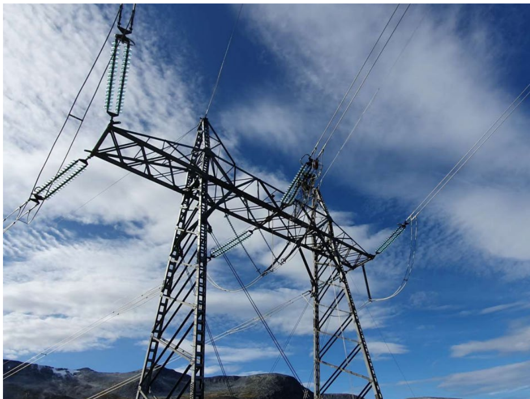
Figur 6 Nærbilde av standardmast med dupleks ledninger. Foto: Statnett.
