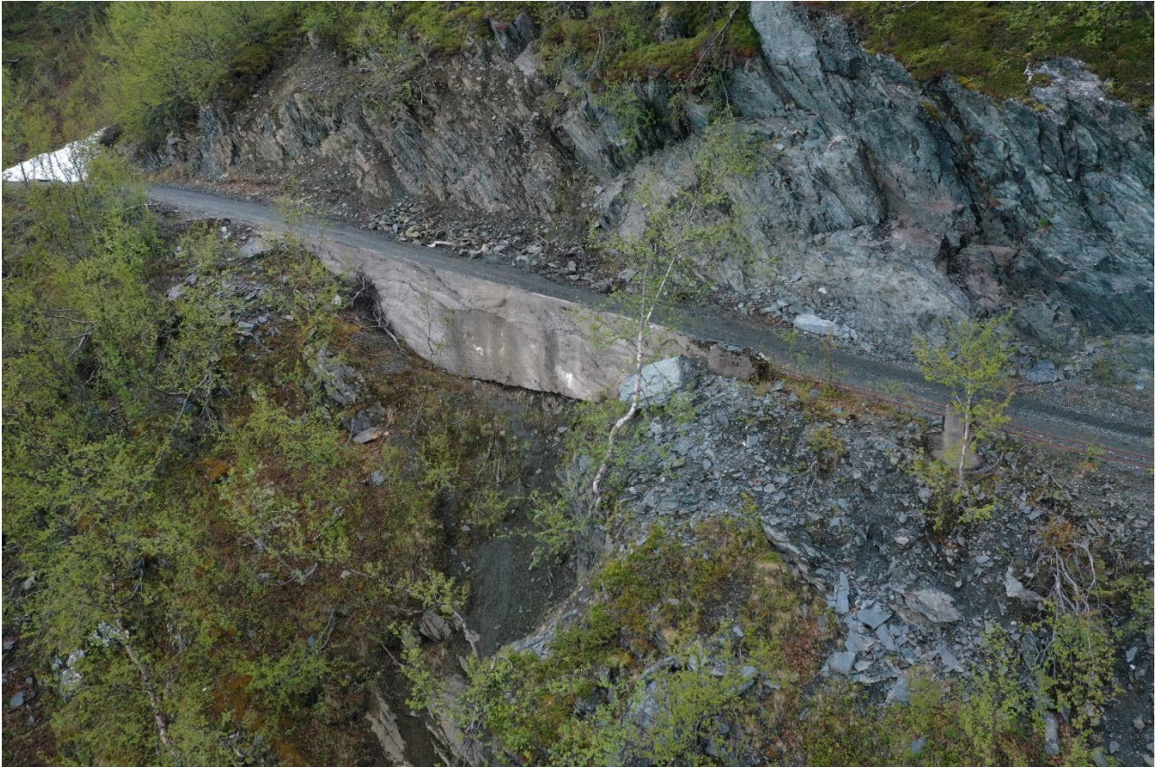
Figur 3-12: Bilde av adkomstvei. Større støttemur som er delvis utrast i fundament. Bilde: Hammerfest Energi
