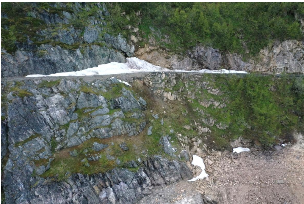
Figur 3-9: Bilde fra siden av adkomstvei. Ser utrasing av løsmasser under betong der hvor snøen ligger høyest på veien. Bilde: Hammerfest Energi
