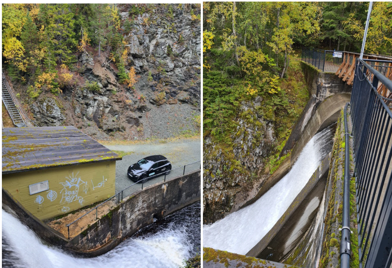
Figur 8 Bratt terreng nedstrøms dam Leirsjøen
