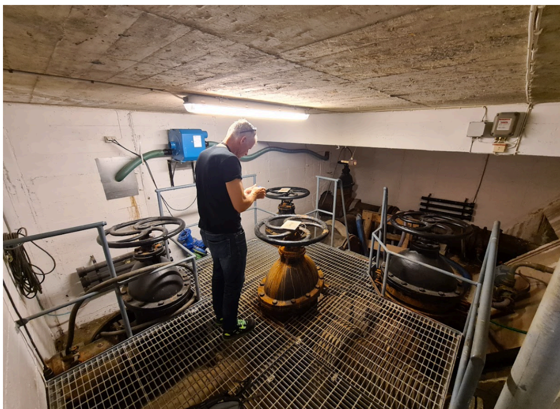
Figur 10 Ventilhuset nedstrøms dam Leirsjøen
