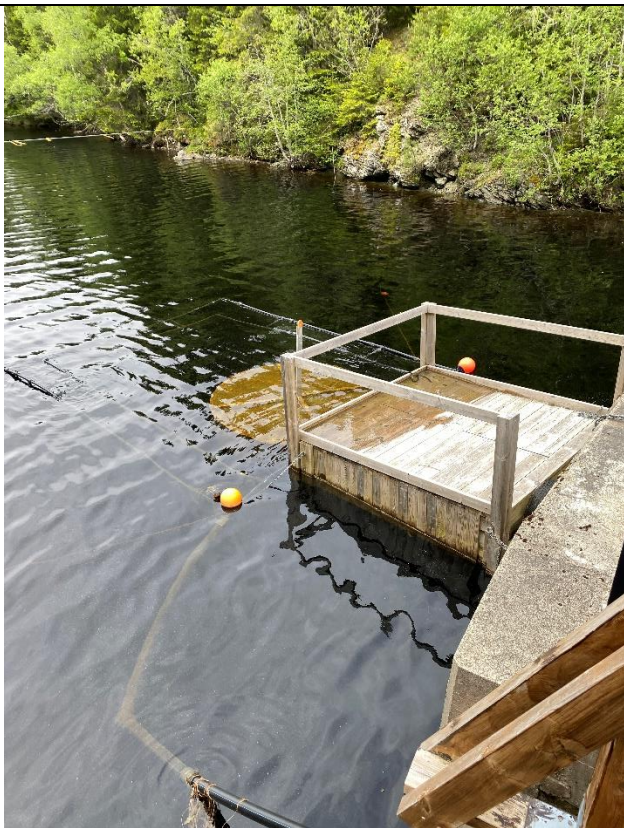
Bobleanlegg og filter over gammelt vanninntak
