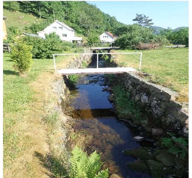
Bekken er senket og flomsikret enkelte steder.
