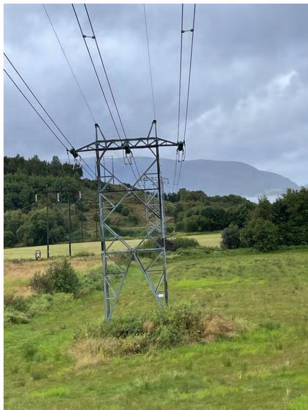
Figur 4: Dagens kraftledninger. 132 kV Hemne-Holla oppført med trestolper til venstre i bildet, og 22 kV duplex linje Sjøa-Holla med stålmaster til høyre.
