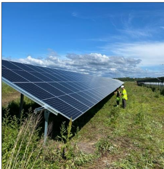
Figur 1-4: Bilde fra Solgrids 4,8 MW solkraftverk i Varberg i Sverige
