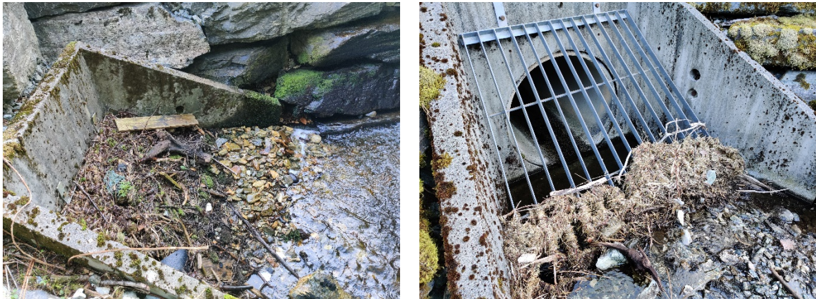
Figur 4-5. Tilstand av bekkeinntak til nedbørsfelt N1 (venstre) og N2 (høyre). Det er synlig mangelpå vedlikehold i begge inntak, med akkumulert drivgods på begge inntaksristene.
