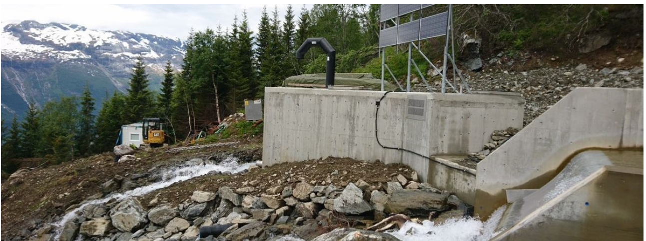
Figur 14 Coandainntak i bratt terreng med overgang til reguleringskammer og rørgate derpå.
