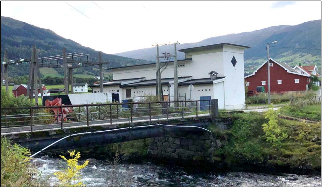
Figur 4-2: Vik sentrum, lokal transformatorstasjon.
