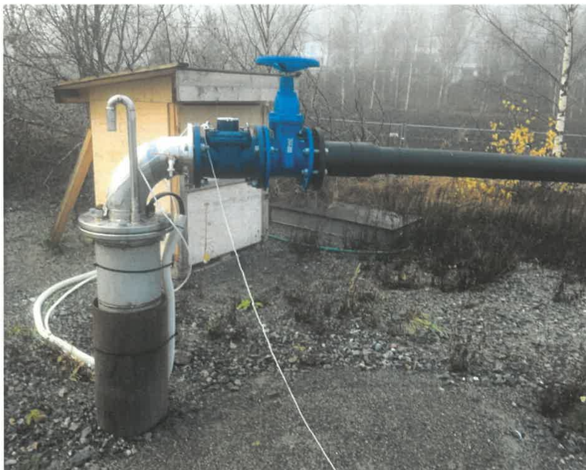
Figur 28: Bilde av tett brønntopp/brønnhodesikring med lufting høyere enn brønntopp – TB4.
