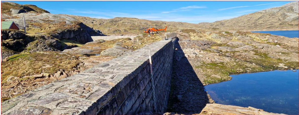
Figur 5 Inntaket ligg ute i magasinet bak helikopteret. Til venstre ser vi lukehuset. Det er straum (1000V-ledning) fram til lukehuset
