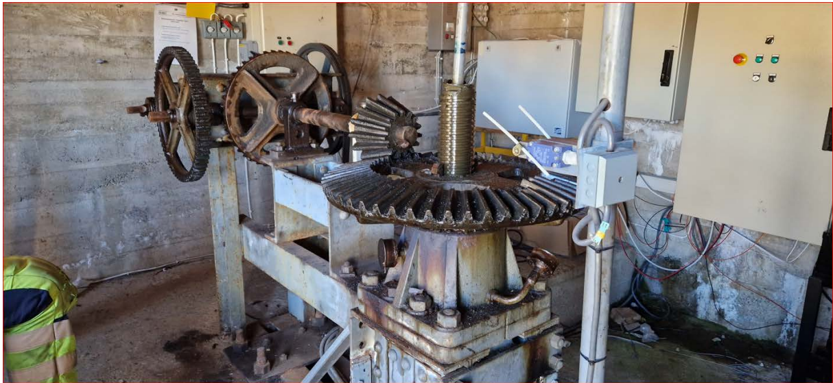
Figur 6 Luka og lukeopptrekket er det originale frå 1937. Luke med opptrekk skal etter planen skiftast sommersesongen 2026. I lukehuset er også utstyr for vannstandsmåling og fjernstyring av luka.
