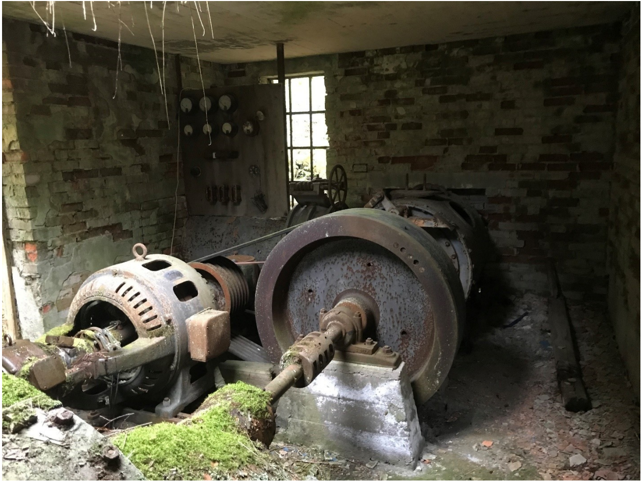
Bilde 2: Brekke kraftstasjon slik den ser ut i dag. Det er noen år siden denne stoppet.
