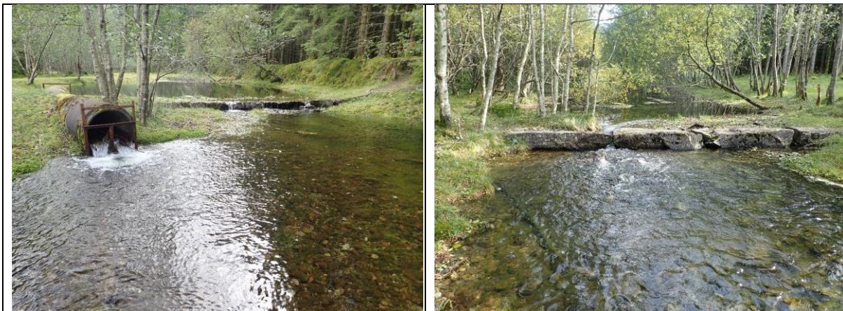
Figur 82. Venstre: Terskelen i det sørlige løpet hvor mesteparten av vannet ledes gjennom et rør. Høyre: Terskelen i det nordlige løpet.
