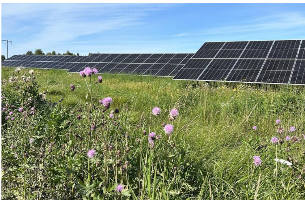
Figur 20 - Vegetasjon i solkraftverk sommeren etter bygging
