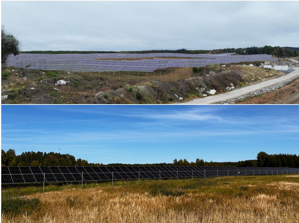
Figur 10 - Inngjerding av solkraftverk
