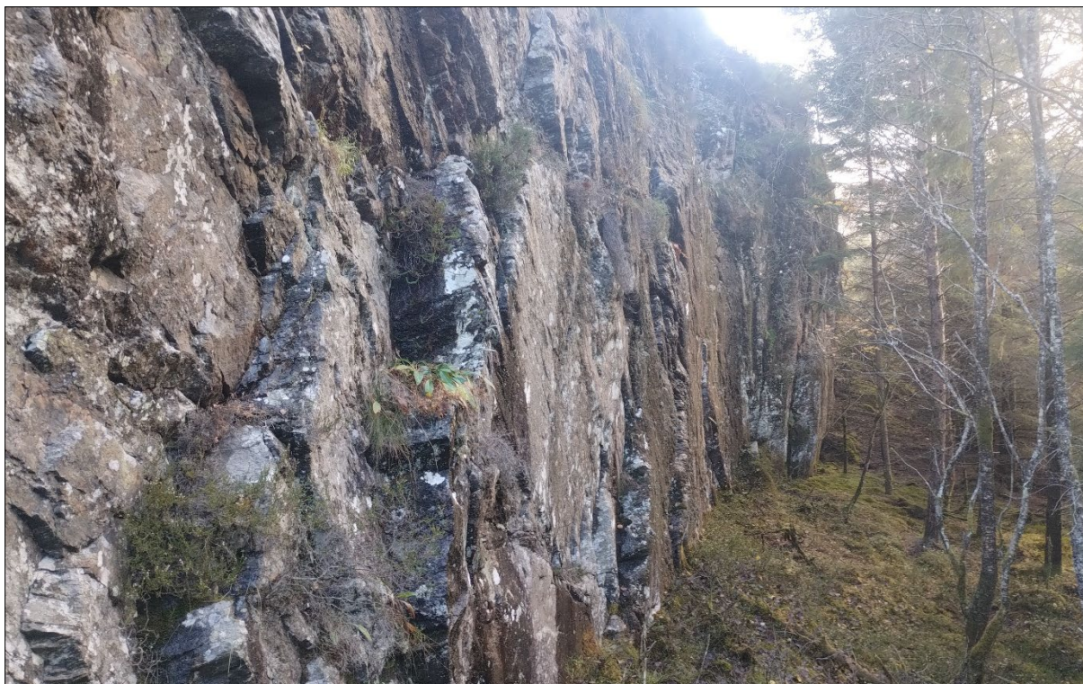
Figur 27: Tilnærma vertikal i nedre delar av fjellpartiet ved infopunkt 10. Det er sprekkdanning som føl fjelloverflata, men flakstrukturane har støtte i grunnen. Det vart observert eit par enkeltblokker nedanfor toppen (Figur 26), men ingen blokker nedanfor hammaren.
