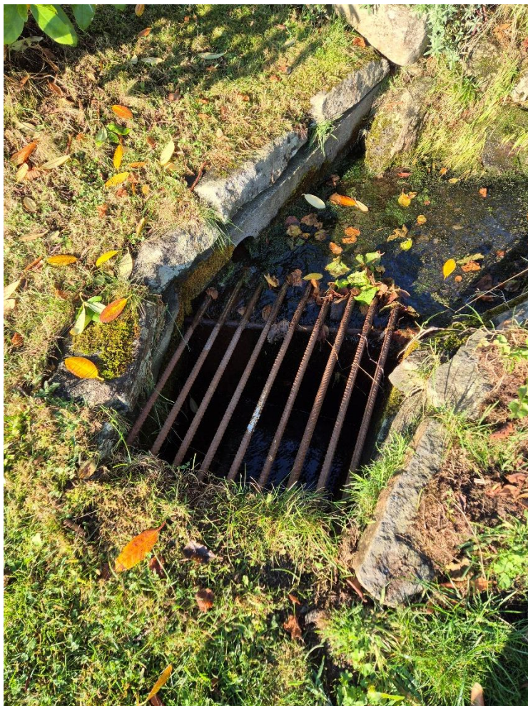
Figur 17 Rist over vasspost ved vegen Pilskogane der bekk på figur 15 kryssar vegen
