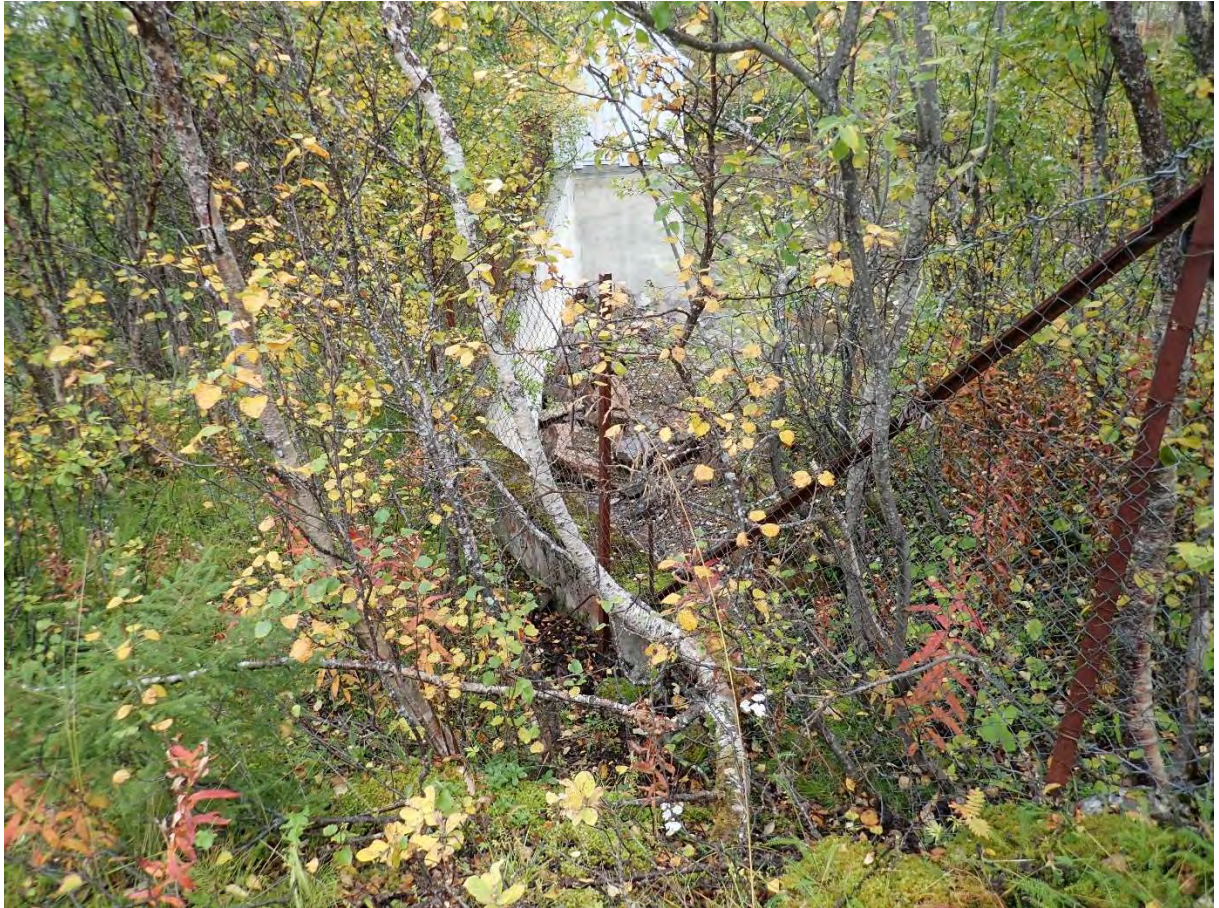
Figur 9. Betong tetting mot ventilhus.
