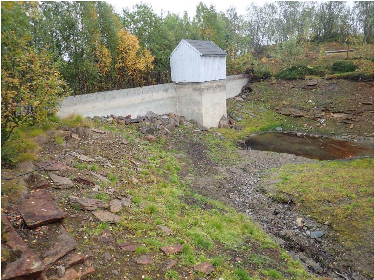
Figur 1. Tomt magasin, ventilhus og betong tetting.
