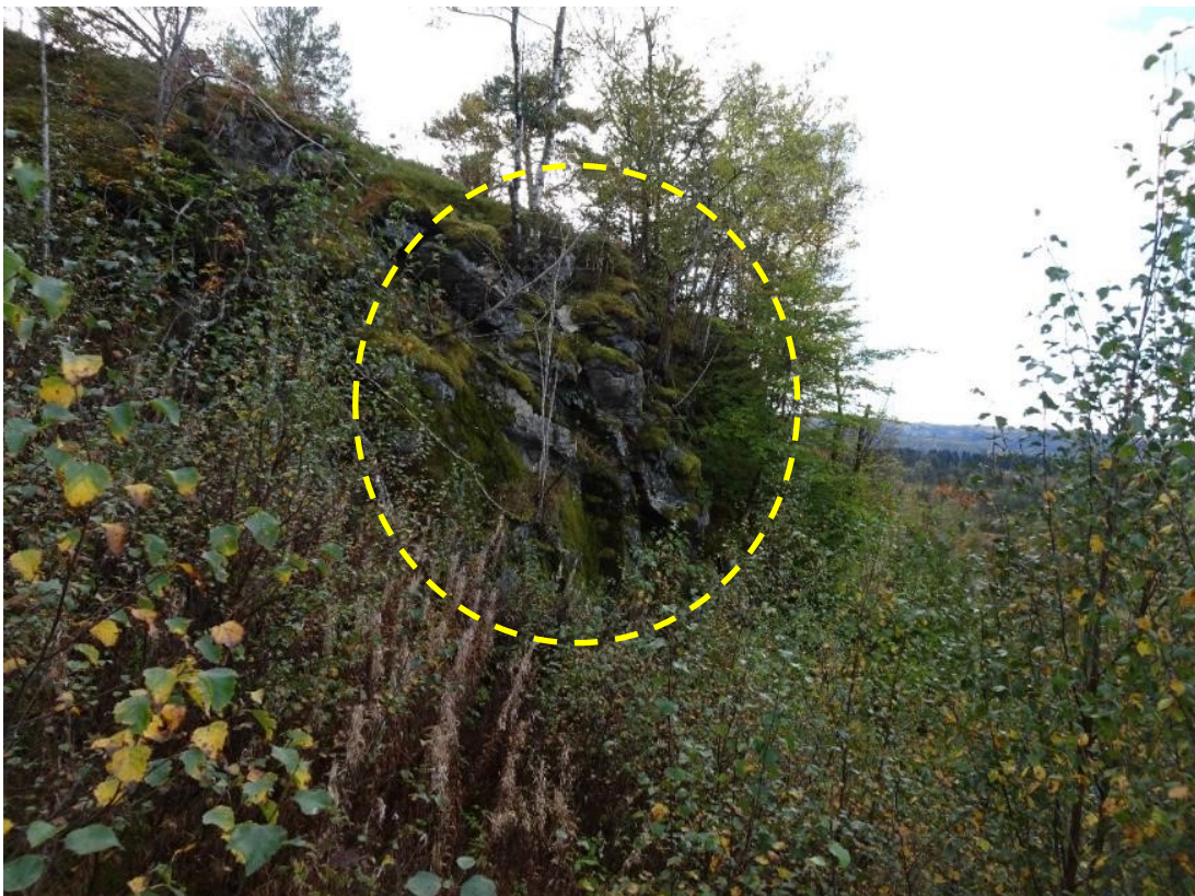
Figur 13. Løse blokker i hengt for aktuell bergskrent (område 2). Sett mot sørvest.
