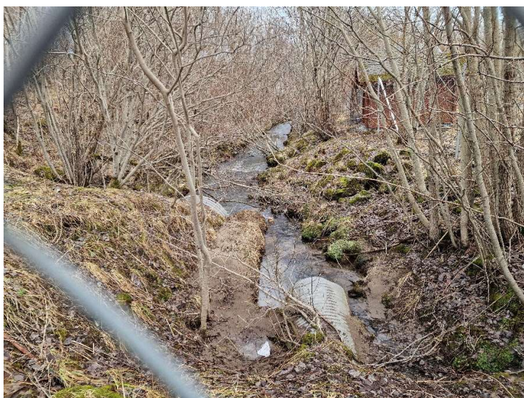
Bilde 3-6 , Utløp av de stotre korrugerte stålrørne til elv ved Idrettsbane.
