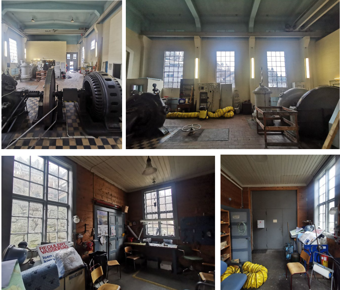
Figur 9 Kraftstasjonens interiør med ny del øvst og gamal del nest.
